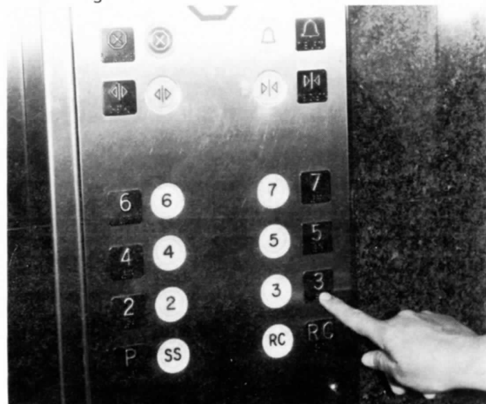
Dans plusieurs édifices publics, les tableaux de contrôle des ascenseurs possèdent des indications en braille.
